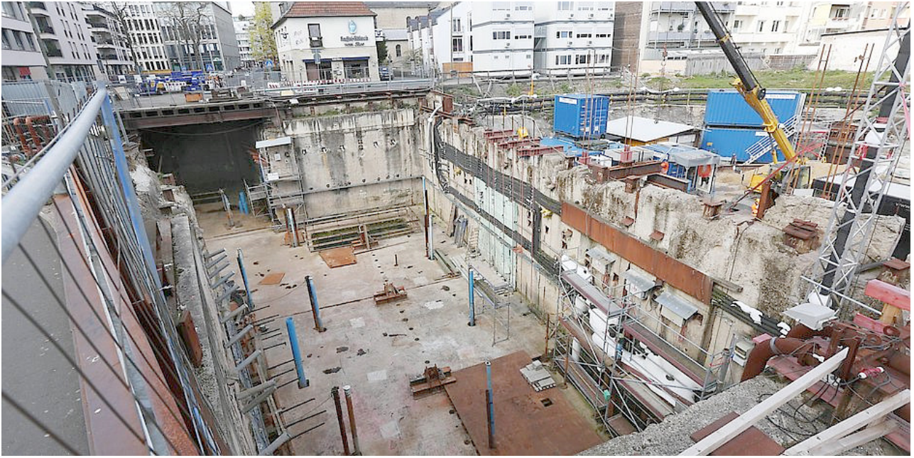
Blick in die Baugrube am Waidmarkt. Im Bild zu sehen ist die Zwischendecke – darunter befindet sich das Gleiswechsel-Bauwerk, das nach Abschluss der Ermittlungen saniert werden muss. Foto: Michael Bause
