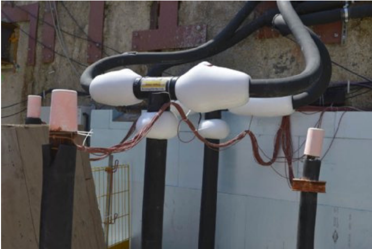
Dieses Gerät kühlt das Erdreich im Schacht.
