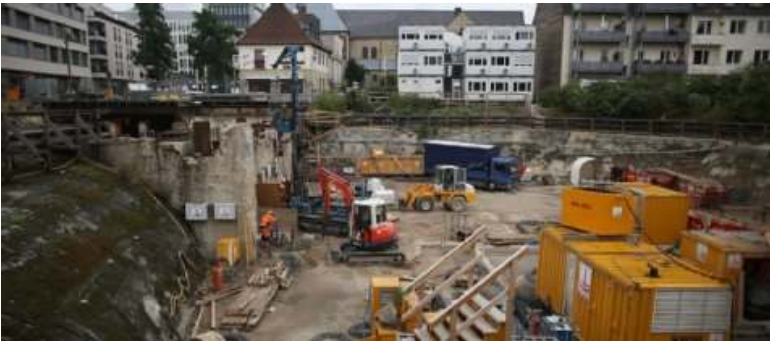
Techniker und Bauingenieure arbeiten am 10.09.2013 in der Absturzstelle des Kölner Stadtarchivs. Foto: dpa
