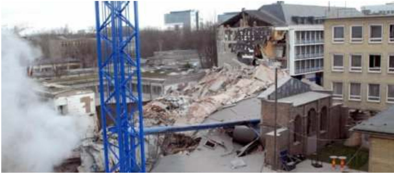
Am 3. März 2009 stürzte das Archiv in die Baugrube der U-Bahn. Foto: Gauger
