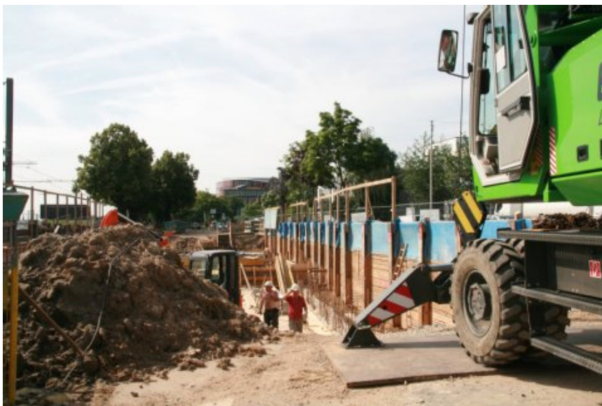
Arbeiten in Zusammenhang mit der Nord-Süd-Bahn in Höhe der Südbrücke – Ende Juli sollen sie abgeschlossen ein. Foto: Süsser
