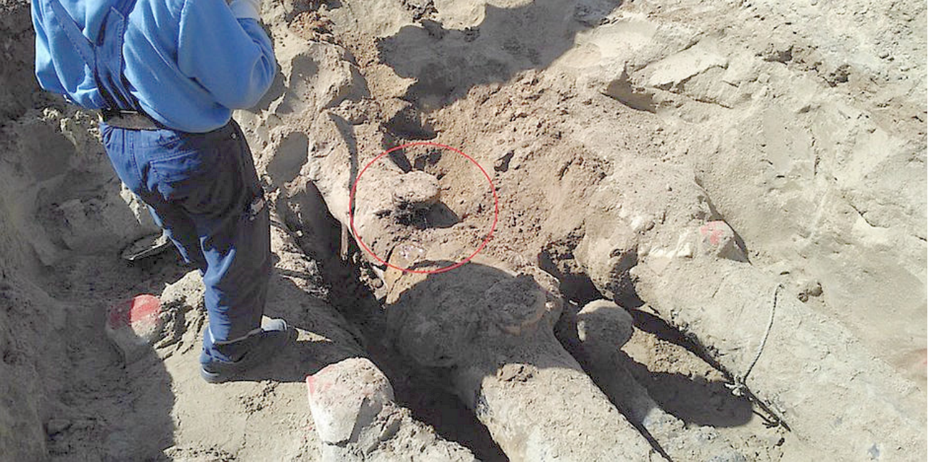
Aus einer Leckage an diesem Rohr trat das Rohbenzin aus. Ein Störfall, der die Menschen im Kölner Süden beunruhigt. Foto: Lyondellbasell
