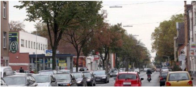
Wegen des Umbaus der Bonner Straße müssen zahlreiche Leitungen verlegt werden – dafür muss ein Großteil der Bäume weichen. Foto: michael bause
